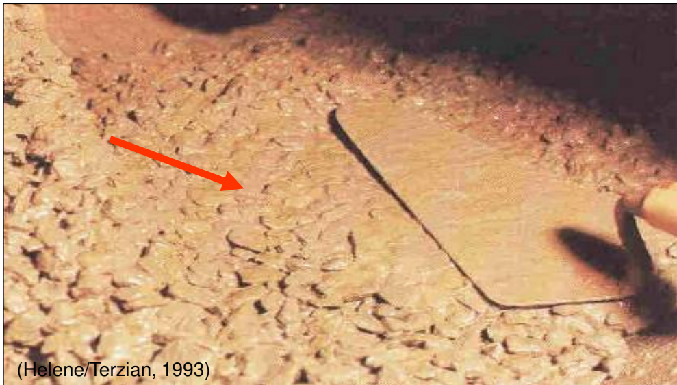
Aparência da mistura com superfície áspera pela falta de argamassa
