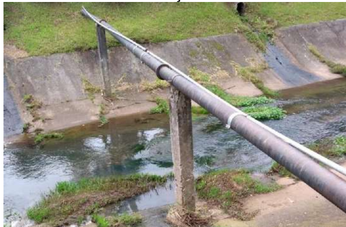
FIGURA 17 – TRAVESSIA AÉREA DE TUBULAÇÃO DA SANEPAR SOBRE O RIO BACACHERI
