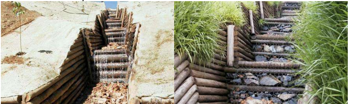
FIGURA 42 – CANALETA ESCALONADA ANTES E APÓS O DESENVOLVIMENTO DA VEGETAÇÃO
