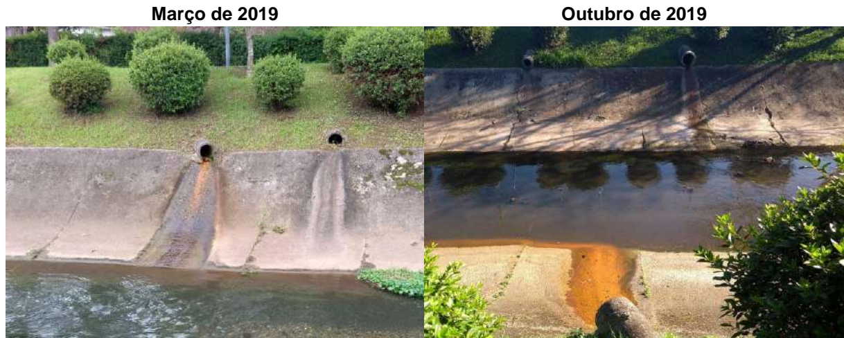
FIGURA 12 – MANCHA ABAIXO DE TUBULAÇÕES DE DRENAGEM INDICANDO A PRESENÇA DE FERROBACTÉRIAS
