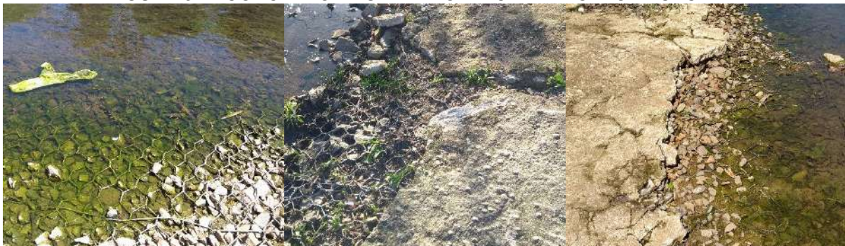
FIGURA 37 – CONCRETO DEGRADADO NA CALHA DO RIO BACACHERI
