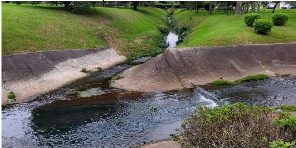
FIGURA 19 – DESAGUE DO AFLUENTE NO RIO BACACHERI E SALTO FORMADO PELO DESNÍVEL ENTRE PEÇAS DA CALHA DE CONCRETO
