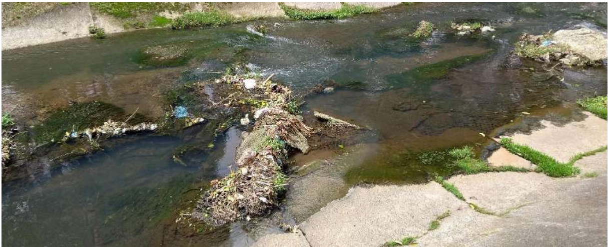
FIGURA 11 – CALHA DANIFICADA PRÓXIMA À ENTRADA DO RIO BACACHERI NO PARQUE
