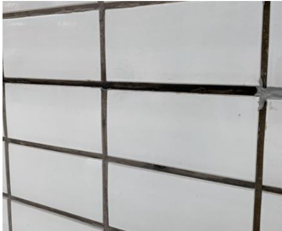
Figura 18 – Rejunta em estado de deterioração (Os autores, 2019).
