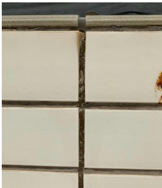
Figura 17 – Presença de manchas no rejunte (Os autores, 2019).
