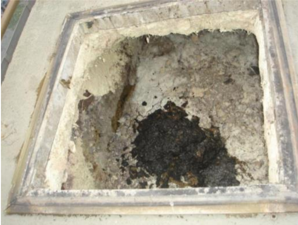
Figura 1 – Deterioração em paredes de concreto de uma ETE (KULISCH, 2011).
