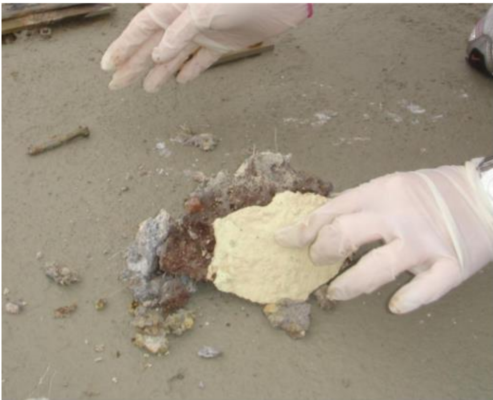
Figura 2 – Amostra extraída de parede de concreto deteriorada (KULISCH, 2011).
