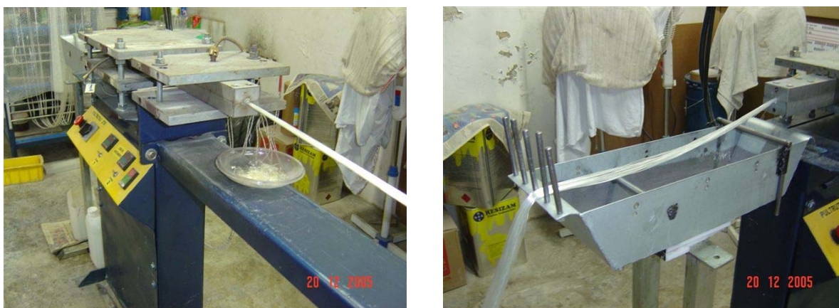
Figura 1 – Unidade térmica do processo de pultrusão e reservatório de imersão (Fonte: acervo particular da empresa WINCRET)
